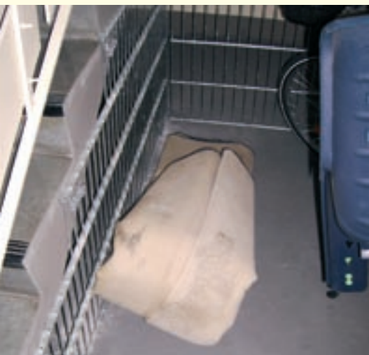
Der Teppich neben der Kellertreppe führt im Ernstfall zu starker Rauchentwicklung.
